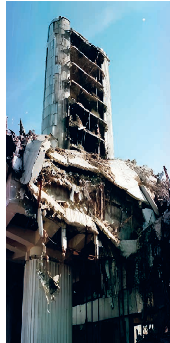
SLIKA 1.6. Zgrada „Oslobodjenja” koja je potpuno uništena tijekom rata u Sarajevu. Urušavanje ove zgrade uzrokovano je granatiranjem i naknadnim požarima koji su izbili na građevini, a nisu bili gašeni. Stručnjaci forenzičkog inženjerstva na ovakvim primjerima mogu dobiti bitne informacije o ponašanju pojedinih građevinskih materijala u ekstremnim uvjetima (slika preuzeta s http://www.oslobodjenje.ba , pristup 26.1.2025.).
